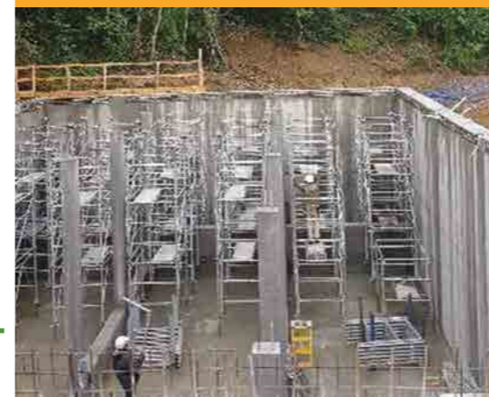
Bassin de rétention d'eaux usées à St Martin en Haut
